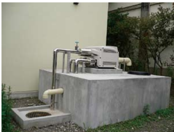
琵琶湖水導水ポンプ
